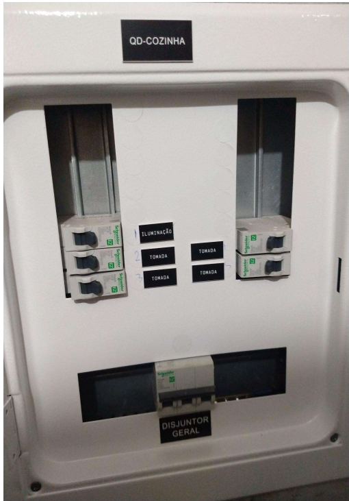
Quadro de Distribuição Cozinha 1º andar
