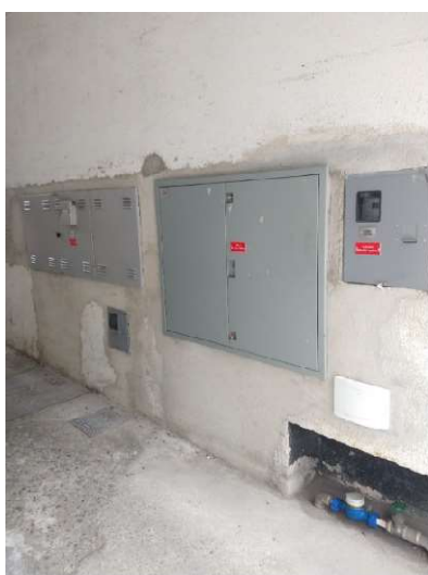
Caixas seccionadoras e bomba de incêndio
