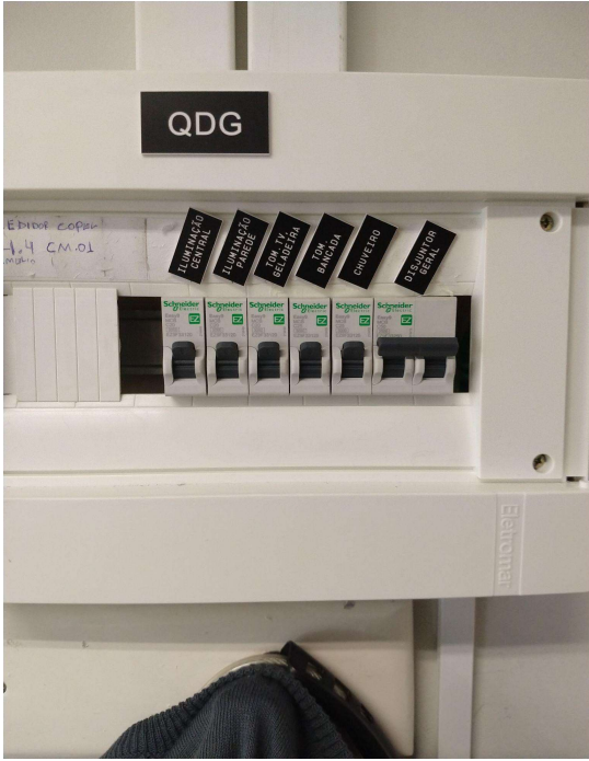
Quadro de Distribuição Barbearia Adequação
