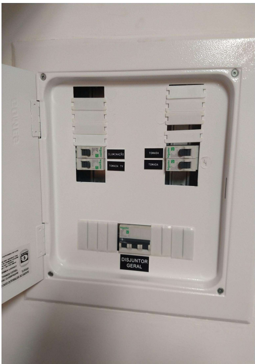
Quadro de Distribuição Alfaiate – 3º andar
