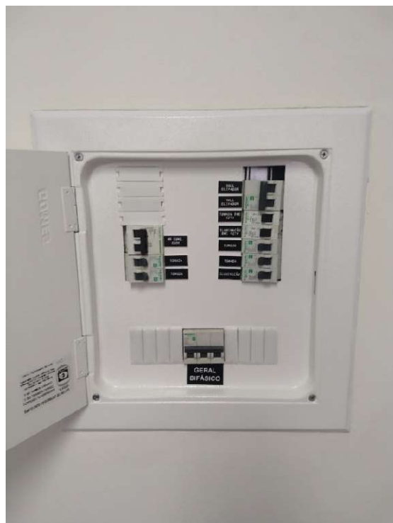
Quadro de Distribuição Sala Diretoria – 3º andar.
