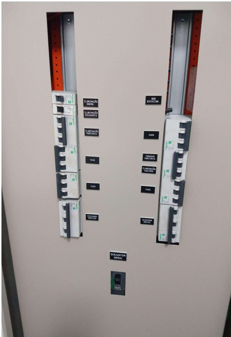
Quadro de Distribuição do Condomínio
