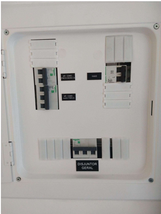
Quadro de Distribuição 2º andar corredor e Servidor IEP
