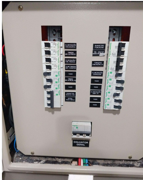
Quadro de Distribuição 2º ANDAR
