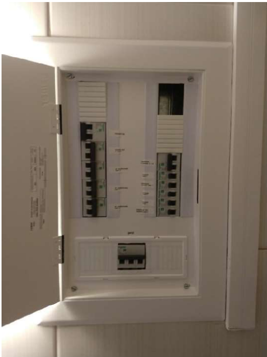
Novo Quadro de distribuição banheiro masc. 4° andar
