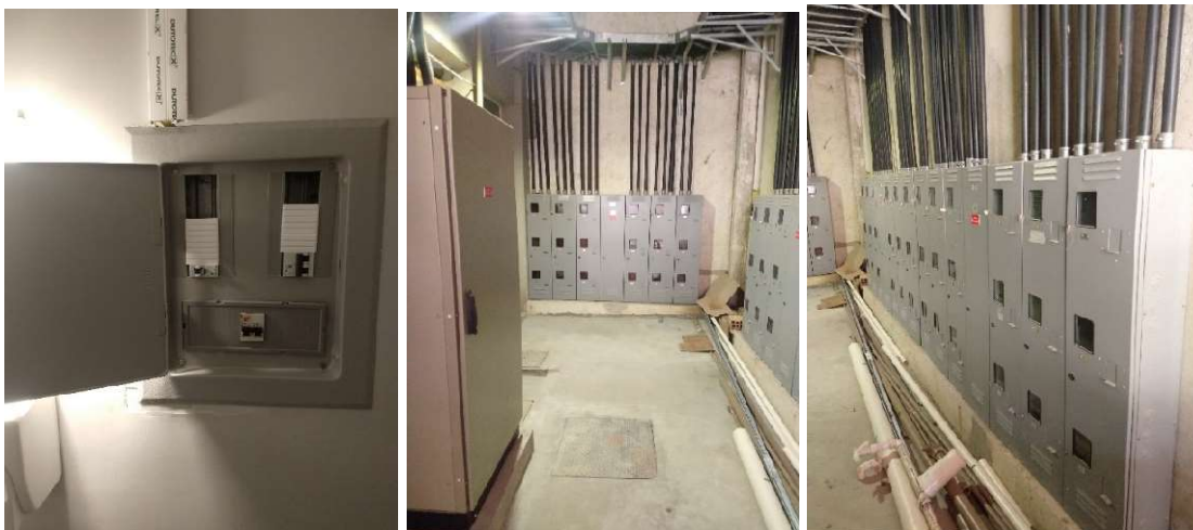
Novo Quadro de Distribuição banheiro 14° andar
