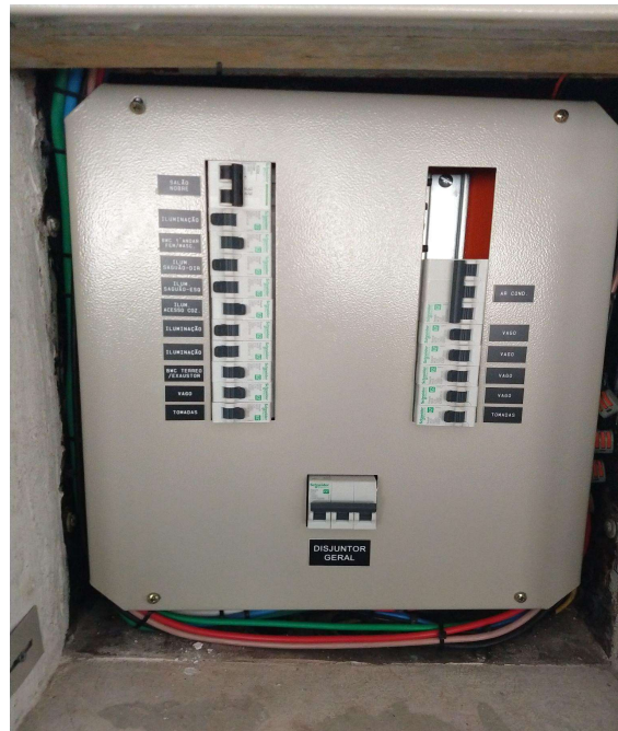
Quadro de Distribuição Hall 1º andar
