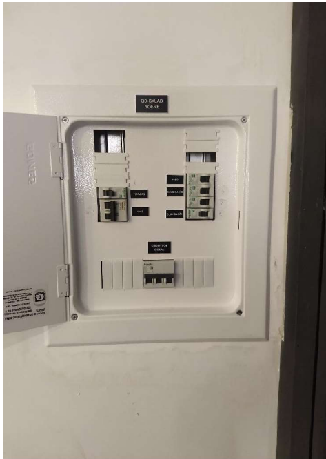
Quadro de Distribuição SALÃO NOBRE – 1º andar
